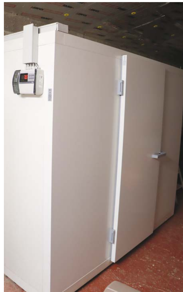
Eine neue Kühlzelle wurde in der Buvette des ASW aufgestellt.
