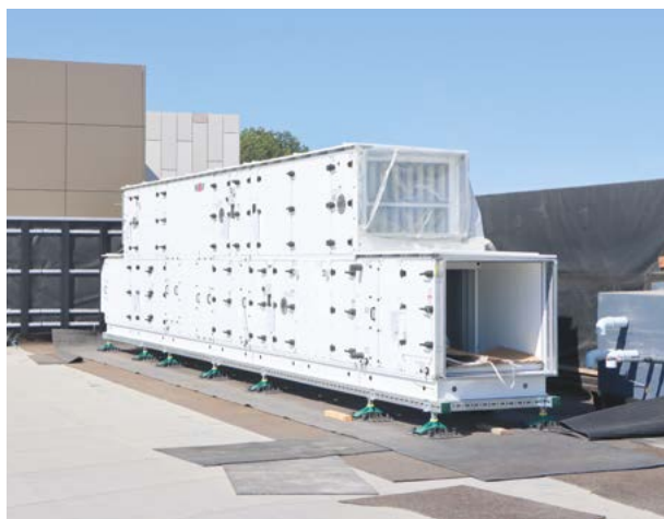
Das Belüftungsgerät für das neue Bildungshaus ist angekommen. © Fernand Arend
