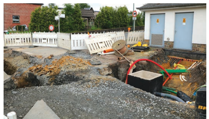
Boxhorn Straßenarbeiten: Momentan laufen die Arbeiten in der Straße „Om Gisel“. Diese werden voraussichtlich bis zum Kollektivurlaub fertiggestellt. Danach werden die Arbeiten in der „Hauptstrooss“ aus Richtung Klerf beginnen. In der Straße „Om Béicherich“ finden zurzeit Arbeiten für die DEA und CREOS statt.
