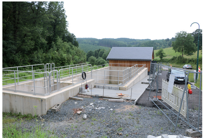
Die technische Installation der Kläranlage in Brachtenbach ist abgeschlossen
