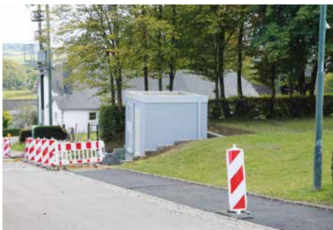
Neuer Trafo in Hamiville
