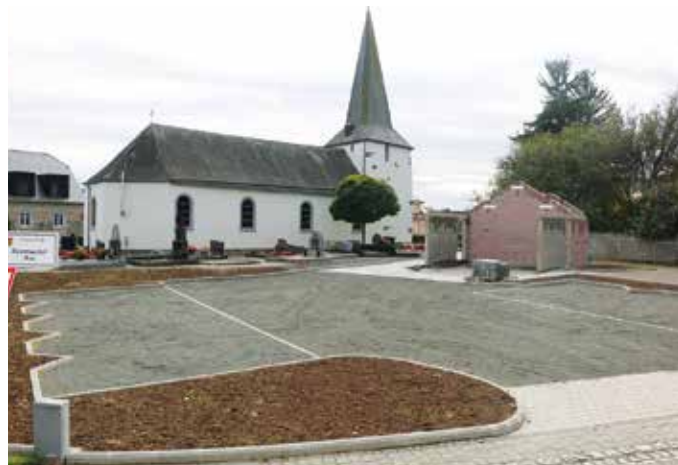
Der neue Parkplatz, die Umgebungs- und die Rohbauarbeiten des Unterstandes beim Friedhof in Niederwampach sind abgeschlossen. Das Dach wird Mitte Oktober gedeckt werden.
