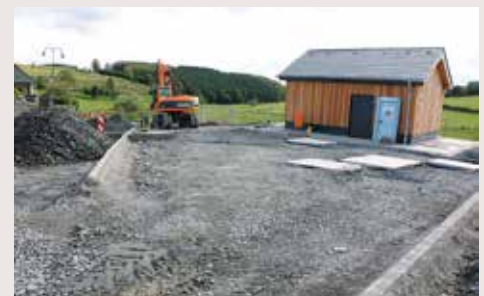
Regenüberlaufbecken in Heisdorf
