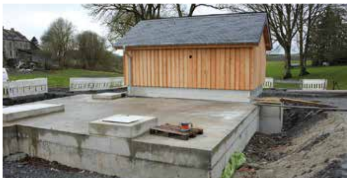
In Allerborn ist das Regenüberlaufbecken mit einer Pumpstation fertig gestellt.
