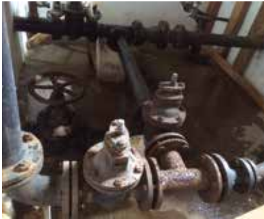
Schieberkaammer am Waasserbehälter zu Helzen viran den Arbichten
