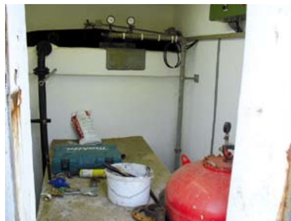
Die alten Leitungen und der rote Kessel der Hydrophoranlage haben ausgedient.
