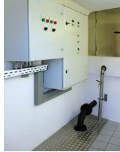
Von diesem Elektronikschrank werden die Daten an den Server übermittelt.
