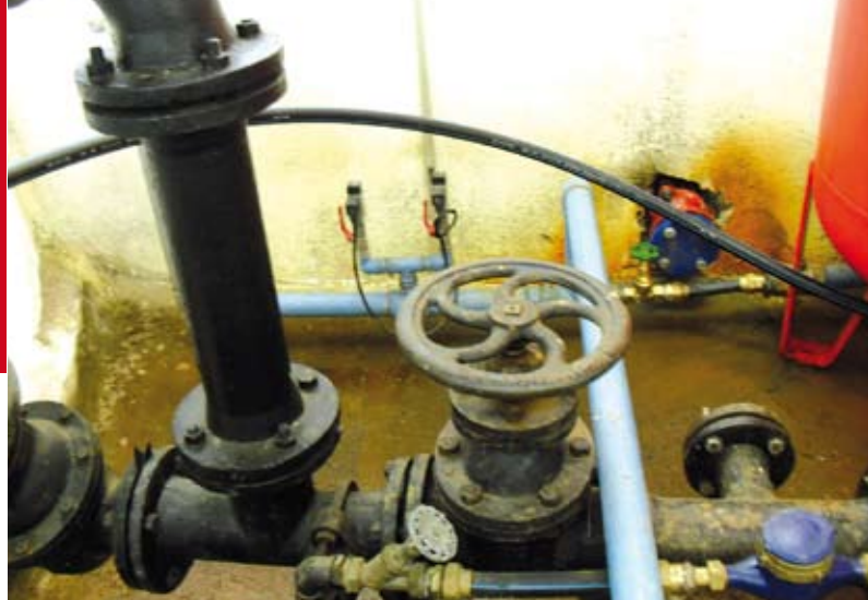
Die alten Leitungen sind den heutigen Richtlinien nicht mehr gerecht.
