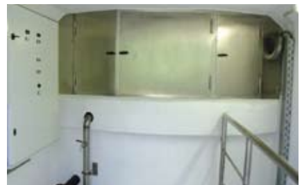
Der Behälter wurde durch eine Edelstahlwand getrennt.
