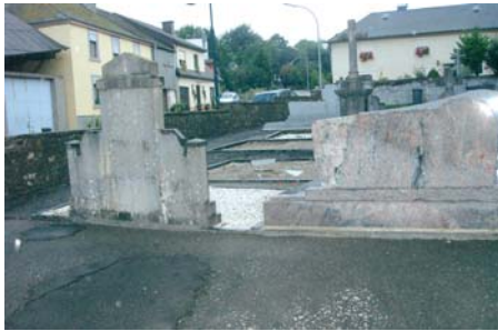
Der Friedhof in Lullingen ist in einem schlechten Zustand
